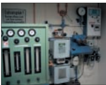
Aggregat zur Mischung und Überwachung des Zündmediums
