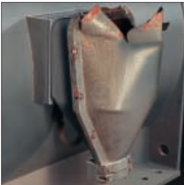
Standard-Anschlusskasten U_N=6\text{kV} , Sollbruchstelle geöffnet
